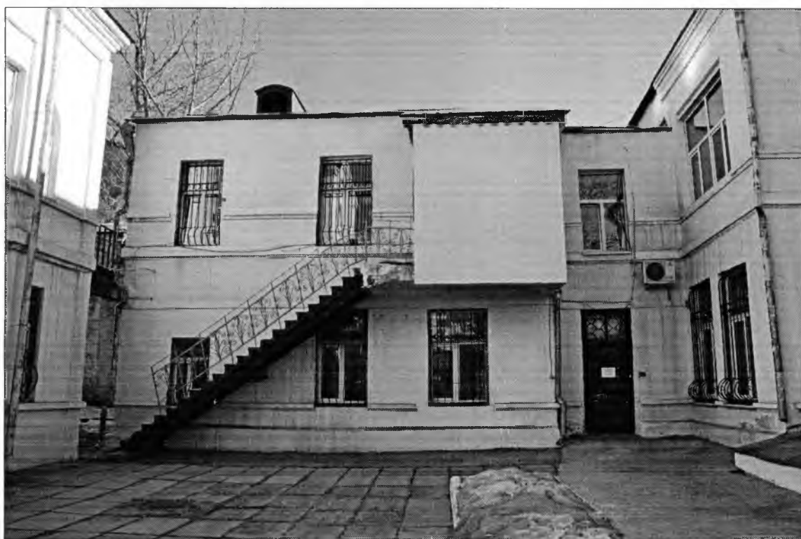
«Усадьба Коновалова. Дом доходный». Дворовый северо-западный фасад. Тамбур с подзором и одномаршевая лестница.
